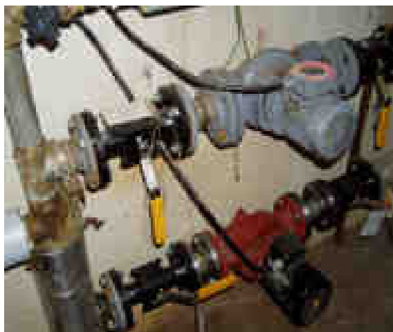
1. kép – Korszerűtlen fűtési szivattyúk
