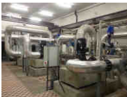
4. kép – Szurdok utca új szivattyúi
