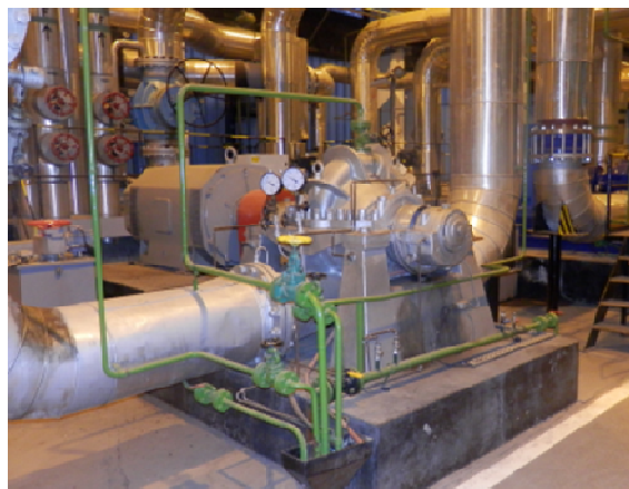
2. kép – Füredi Fűtőmű régi keringtető szivattyú
