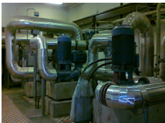
3. kép – Szurdok utca régi szivattyúi
