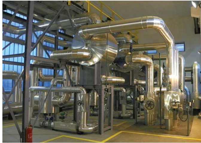
A hőkiadó állomás új, megnövelt kapacitású gépészeti berendezései
