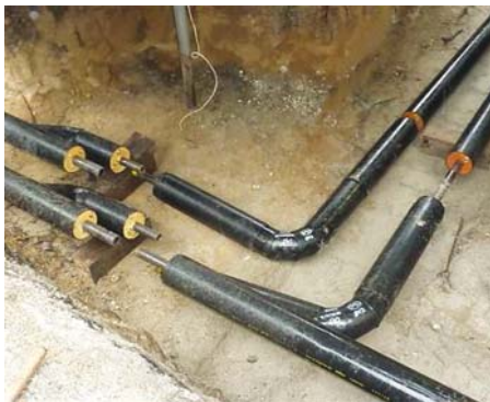
Felhasználói hőközponthoz kiépített előszigetelt, közvetlenül földbe fektetett primer vezeték
