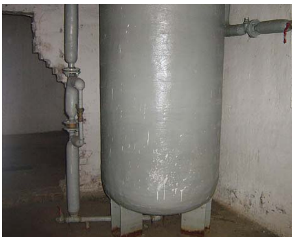
Gyenge hőszigetelésű, nagy energiavesztésű használati melegvíz tároló egy szolgáltatói hőközpontban a fejlesztés előtt
