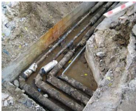
Szolgáltatói hőközpont gyenge hőszigetelésű, nagy hőveszteségű szekunder vezetéke
