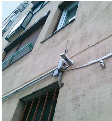
A hőközpont informatikai támogató egysége teszi lehetővé a távoli kezelést a felügyeleti központból
