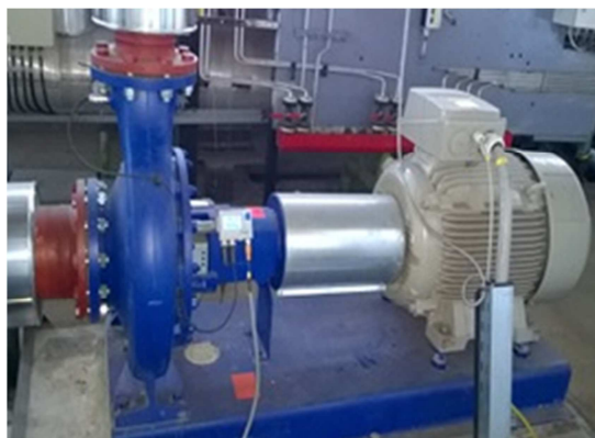
4. kép – Rákoskeresztúri Fűtőmű új keringtető szivattyú
