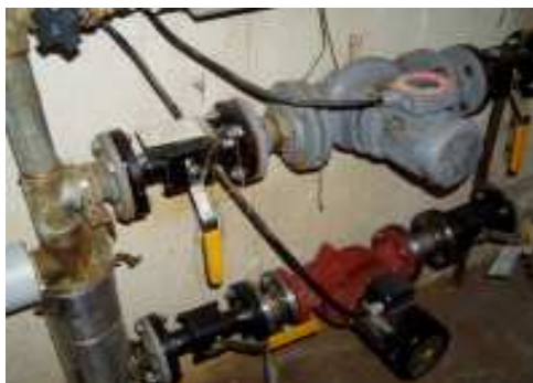
1. kép – Korszerűtlen fűtési szivattyúk
